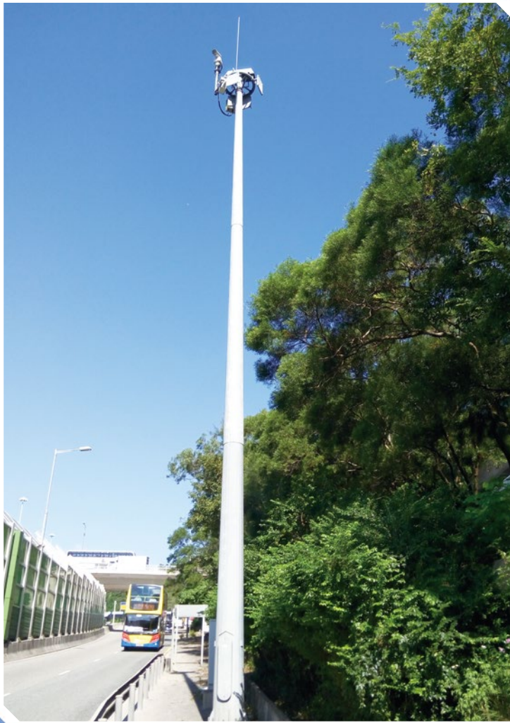
閉路電視攝影機 CCTV camera
