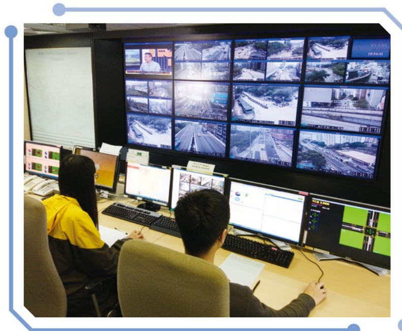
「區域交通控制系統」控制中心 Area Traffic Control Centre
