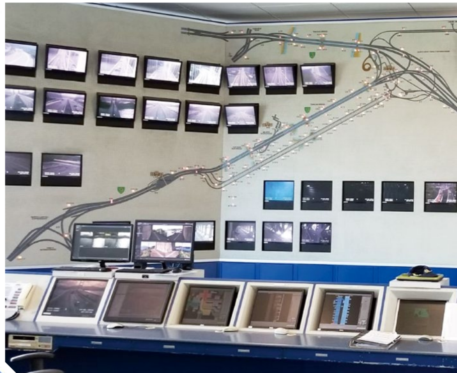
青馬控制中心 Control centre of the Tsing Ma Control Area
