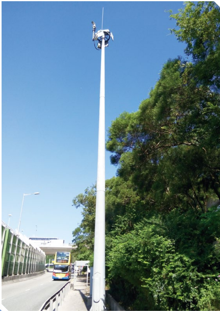
閉路電視攝影機 CCTV camera
