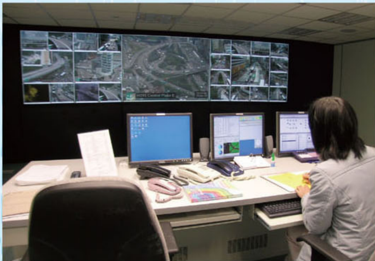
九十年代的交通燈控制中心 Area traffic control centre in the 1990's
