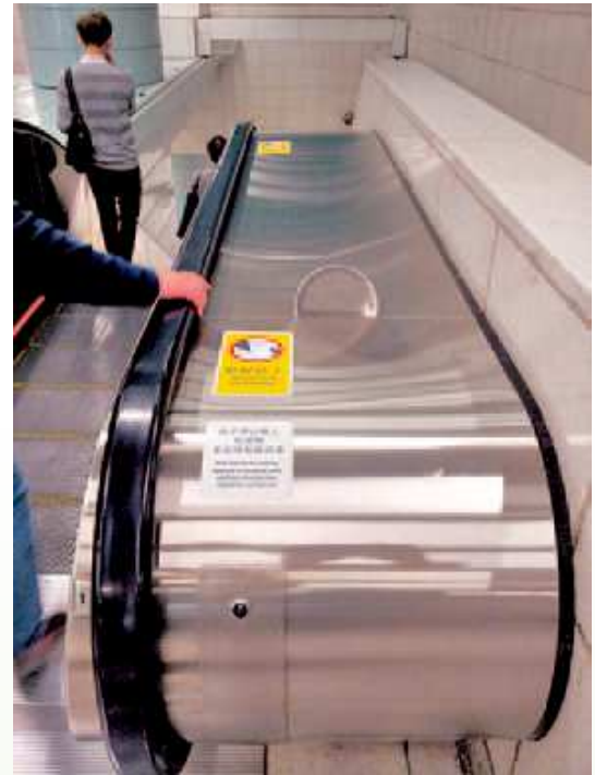
扶手電梯附設發聲器 Audible device at escalators
