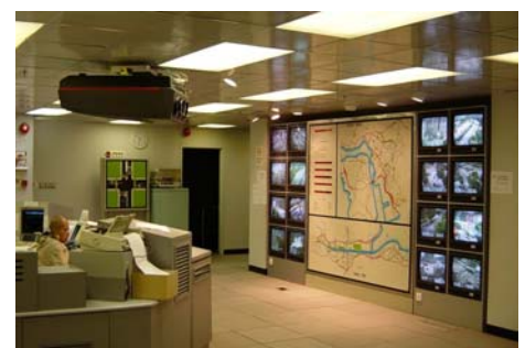
區域交通控制系統控制室
