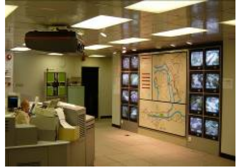
區域交通控制系統控制室
